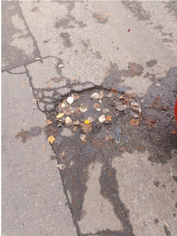
10. Osadná – výtlk na chodníku
