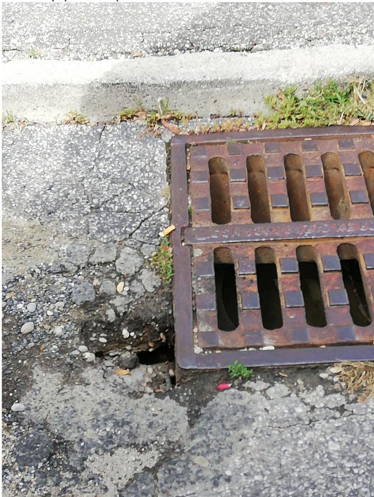
18. Rozvodná – prepad v okolí vpuste
