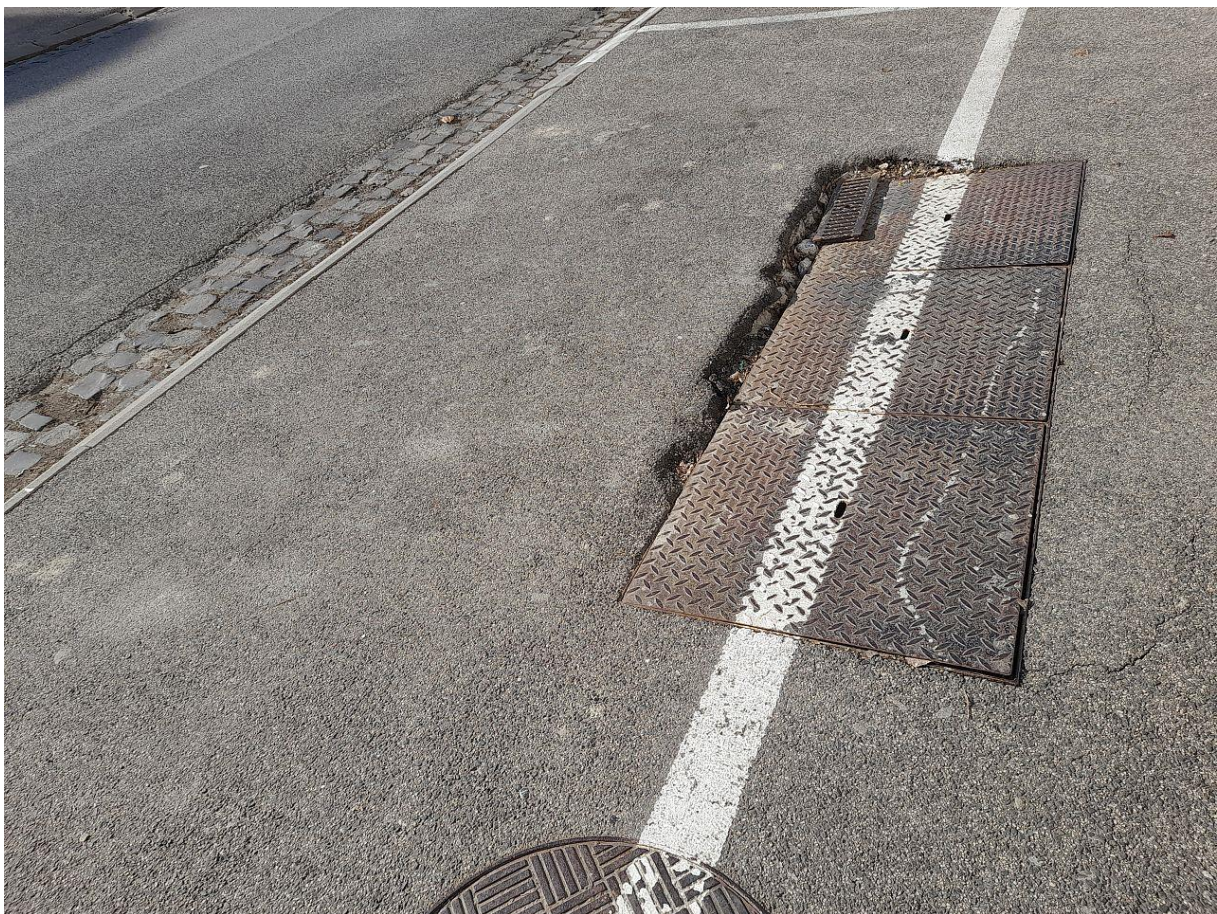
15. Škultétyho – poškodený chodník
