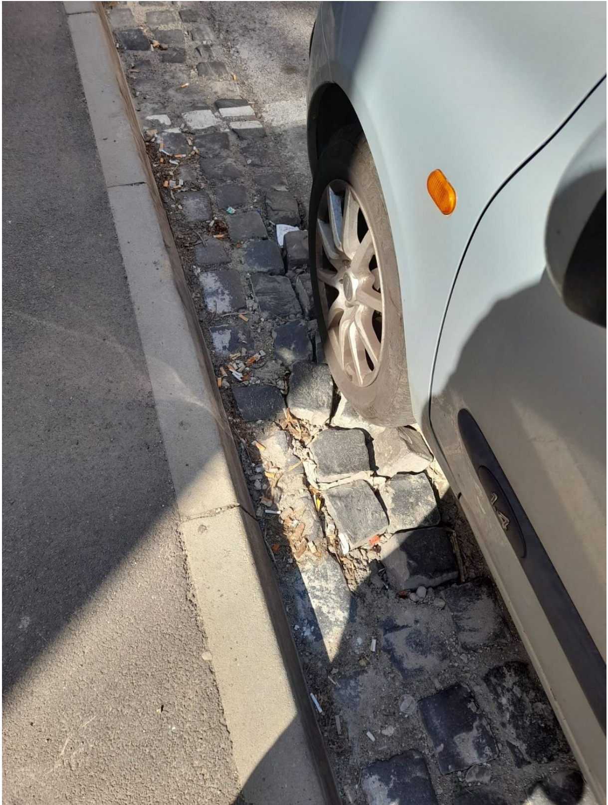
12. Česká – poškozený obrubník
