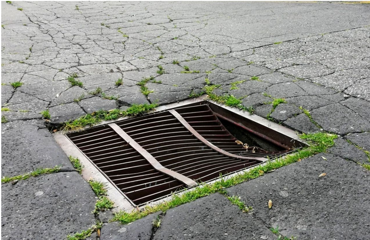
26. Moravská – poškodenie viacerých kanálov
