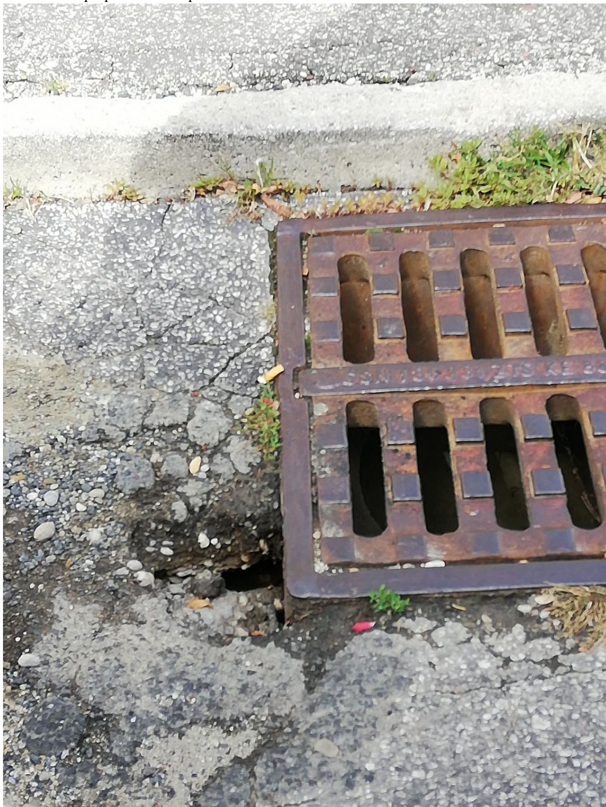
18. Rozvodná – prepad v okolí vpuste
