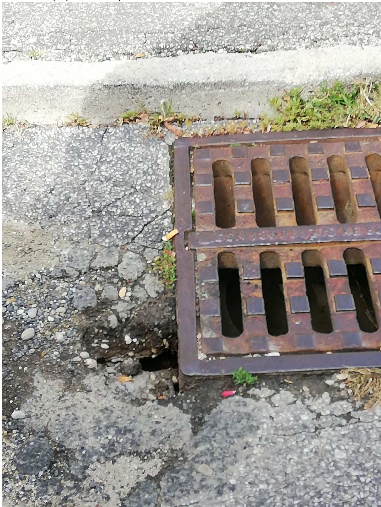
18. Rozvodná – prepad v okolí vpuste
