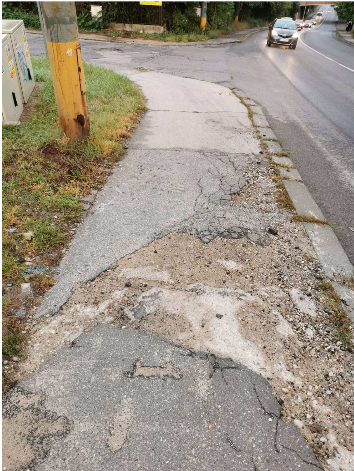
19. Ďumbierska – poškodený chodník
