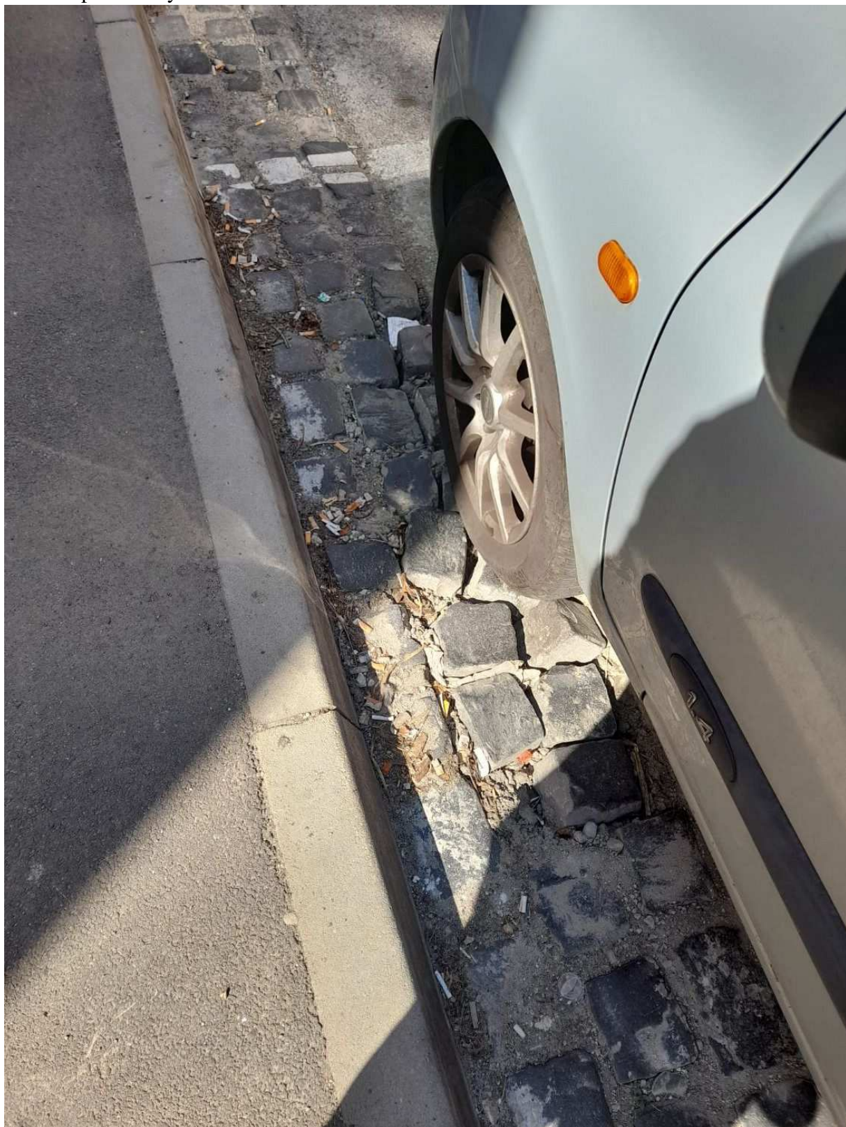
12. Česká – poškozený obrubník
