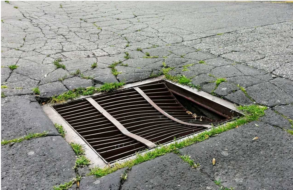
26. Moravská – poškodenie viacerých kanálov
