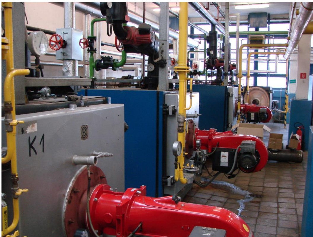
Pohľad na nízkotepelné kotle s pretlakovými horákmi v kaskáde
