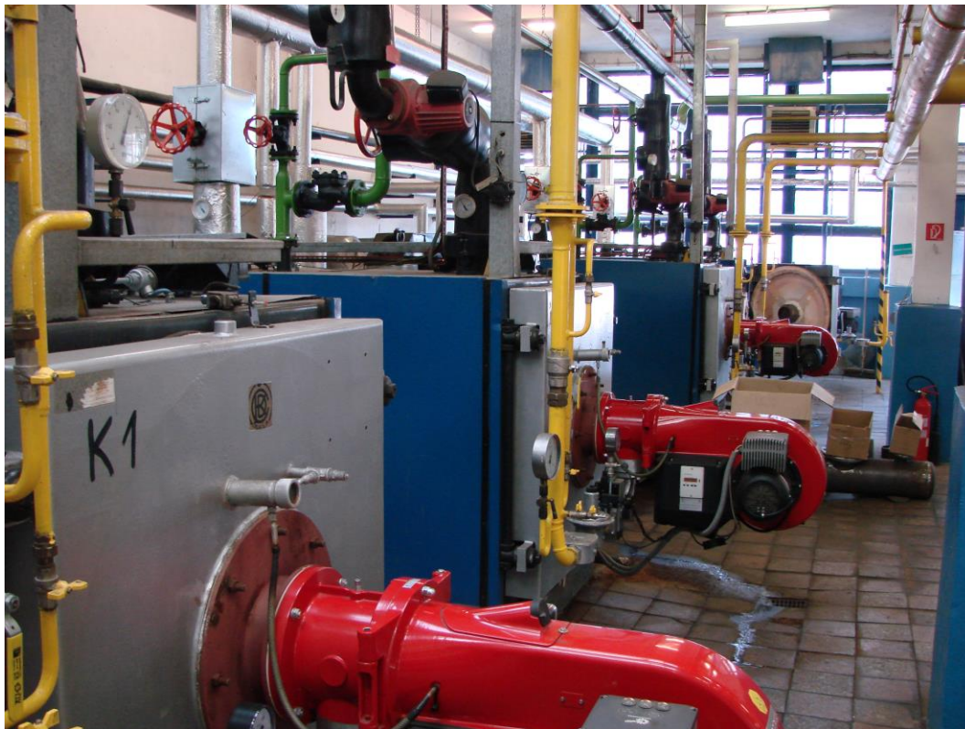
Pohľad na nízko-teplotné kotle s pretlakovými horákmi v kaskáde
