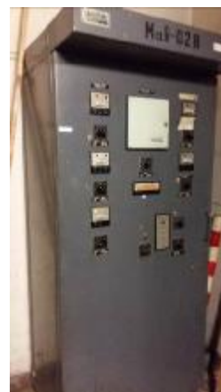
Obr. 40 – Nefunkčný rozvádzač MaR
