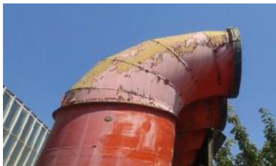
Obr.32 – Zdegradované nasávacie potrubia v exteriéri
