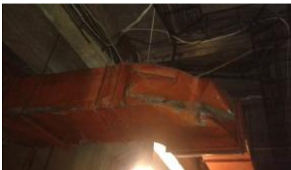
Obr.31 – Znehodnotené / poškodené časti VZT potrubí
